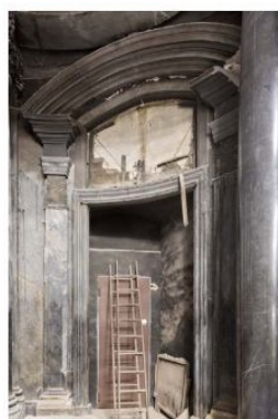
Figura 84 Vista degli intonaci da restaurare nel vestibolo NW.
